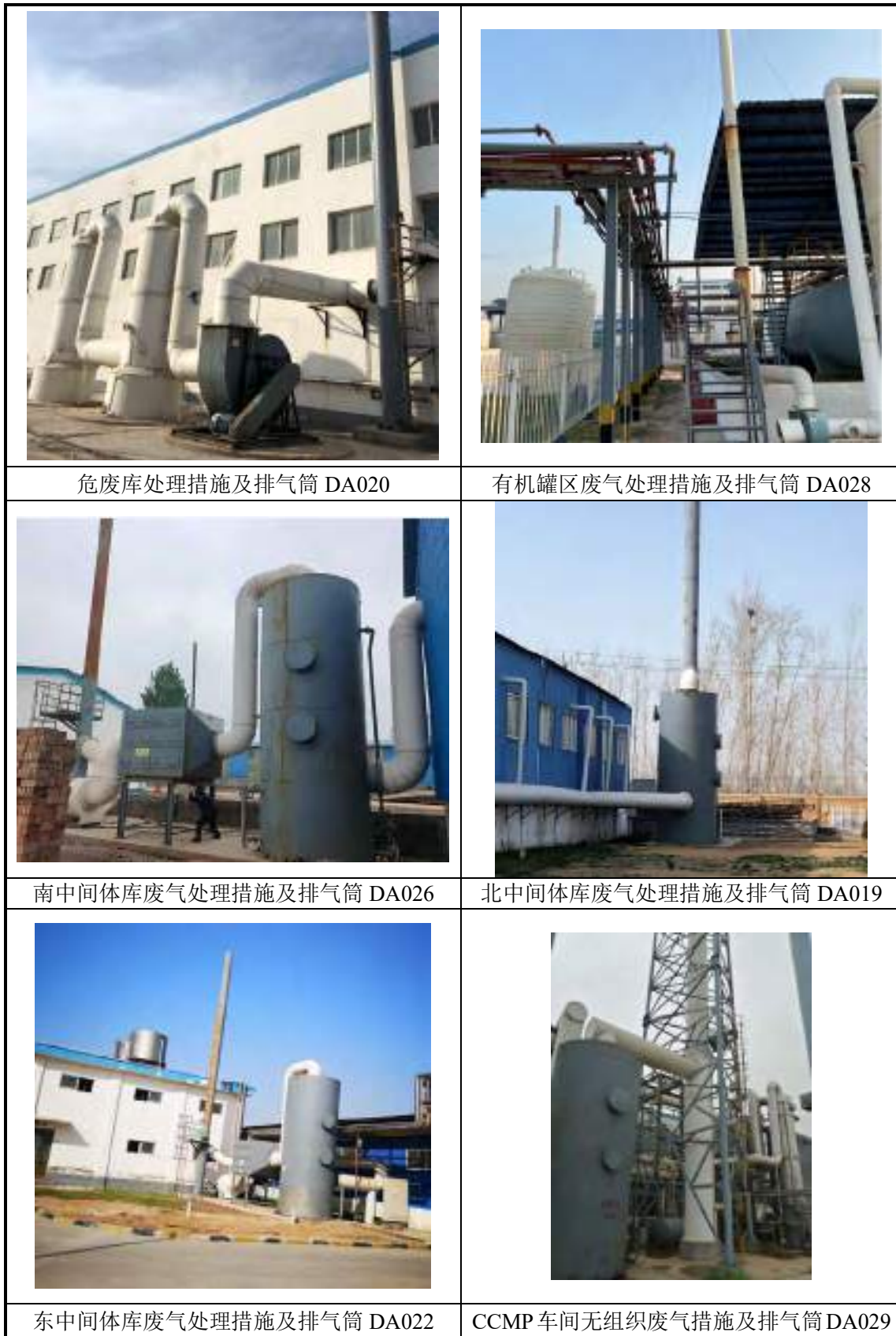
图 3.2-6 厂区现有各处理措施现场图（部分）
